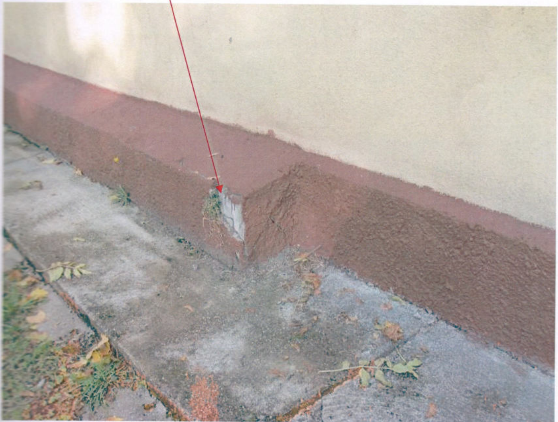
Западный фасад западного объёма: стена и цоколь оштукатурены, окрашены, в уровне первого этажа на стене установлены наружный блок кондиционера и труба вытяжки. На цоколе наблюдаются трещины по штукатурке, локальные нарушения штукатурного слоя. Отмостка бетонная. Оконные заполнения – стеклопакеты.
