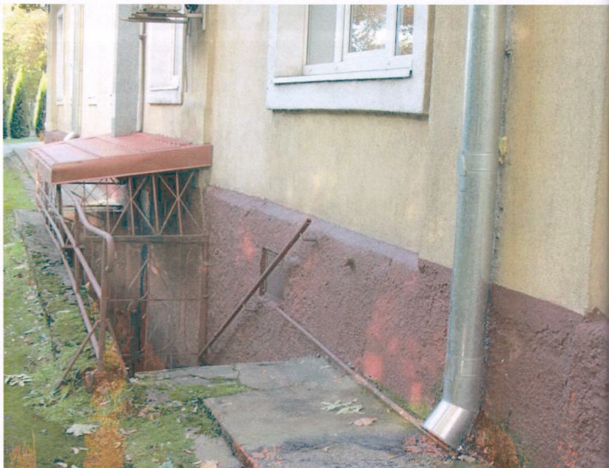
Западный фасад основного объема: стена и цоколь оштукатурены, окрашены. В уровне подвала выполнен приямок с бетонной лестницей, с металлическим навесом. Отмостка бетонная. Водоотвод производится по козырьку здания, в местах затекания воды на цоколе наблюдаются следы излишнего увлажнения.
