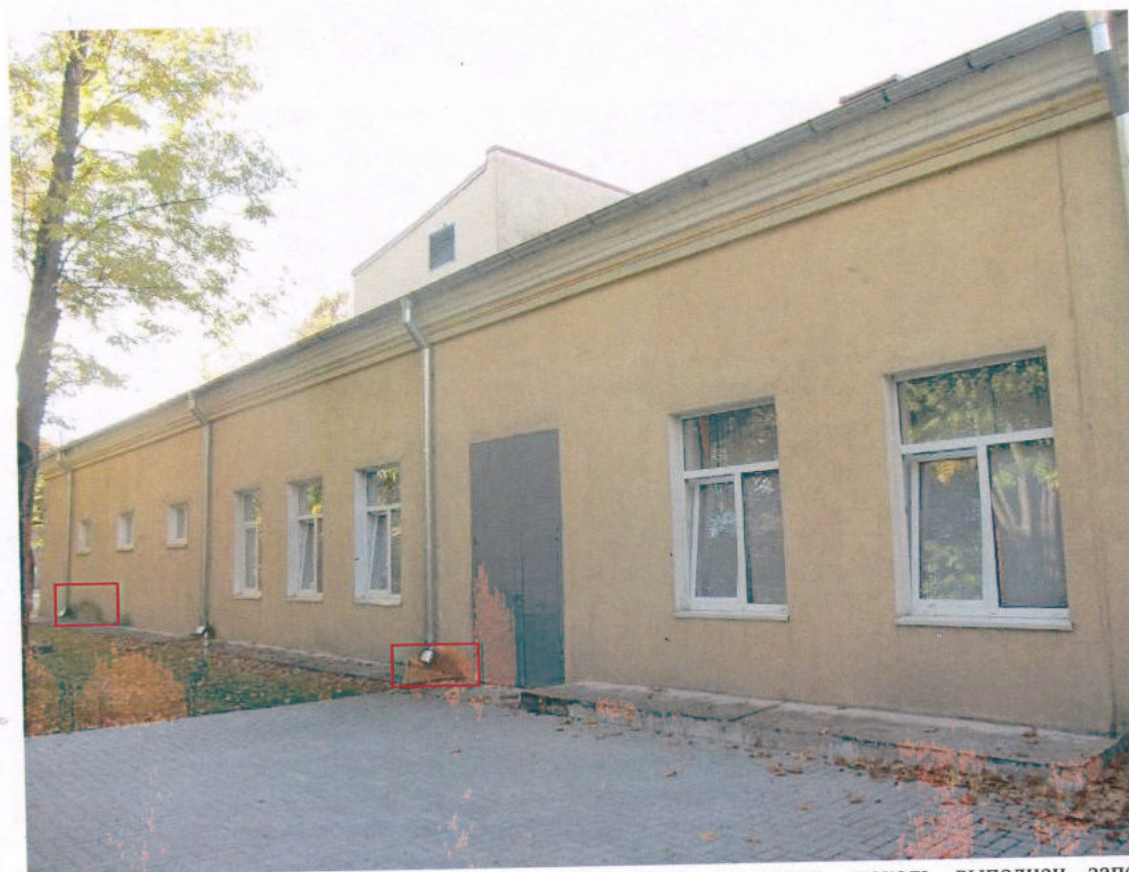
Восточный объём, восточный фасад: стена оштукатурена, окрашена, цоколь выполнен заподлицо. Водосточные желоба и трубы новые. На стене рядом с водосточными сливами наблюдается излишнее увлажнение. Оконные заполнения – стеклопакеты. Дверь металлическая. Отмостка саломанная, бетонная.
