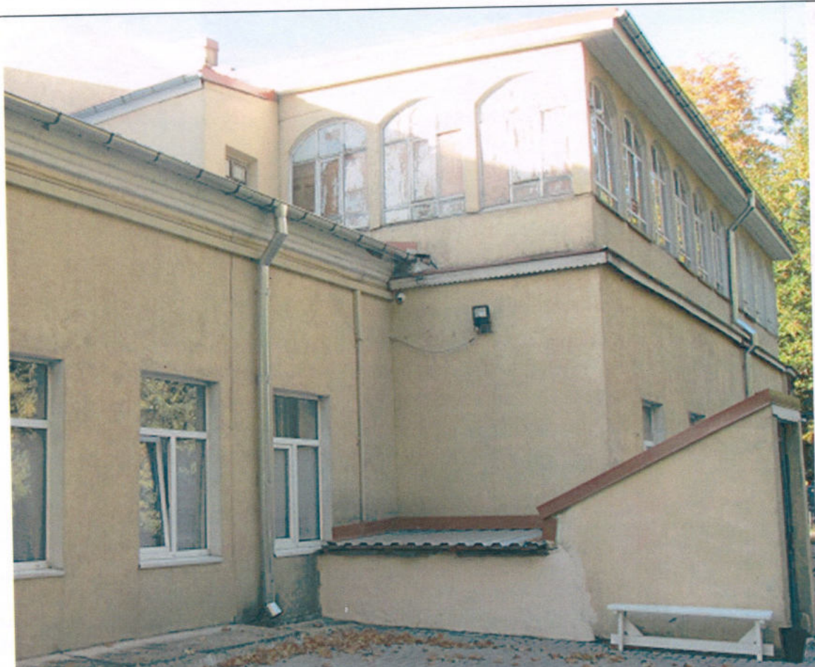
Основной объём, южный фасад: во внутреннем углу уровне подвала и первого этажа выполнен тамбур вход в подвал под собственной односкатной крышей.
