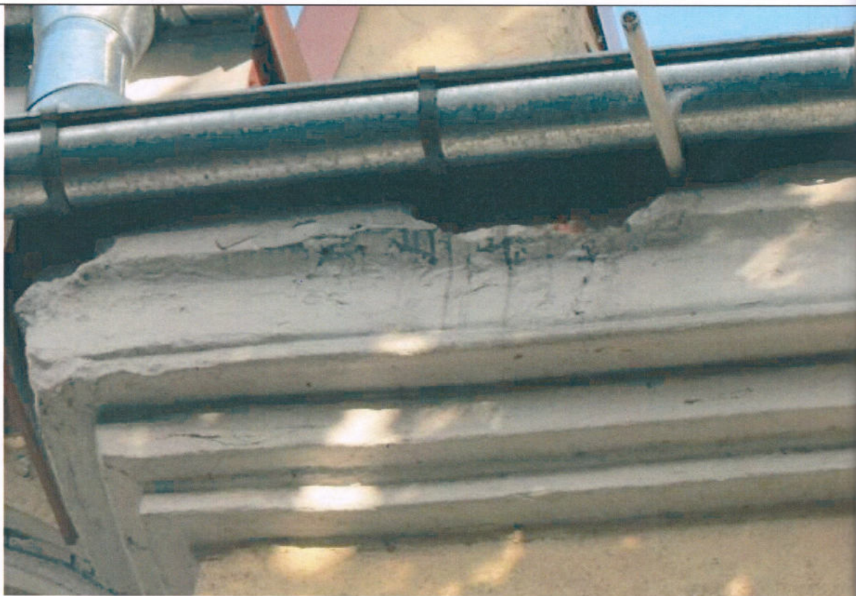
Западный фасад западного объема: на венчающем карнизе локальные выбоины.
