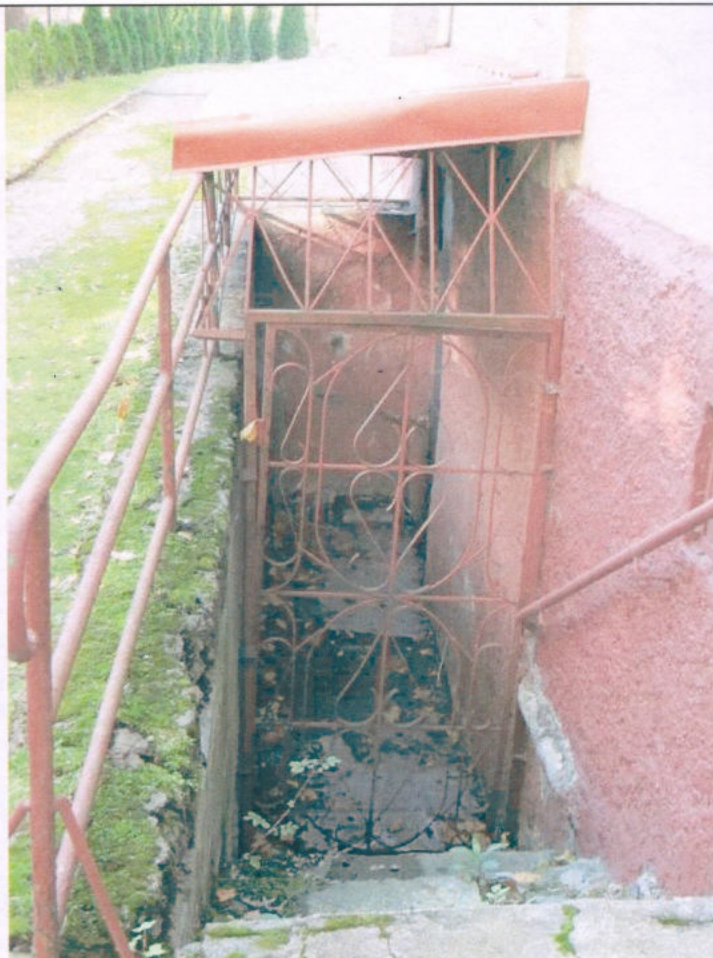
Западный фасад основного объёма: на стенах прямка нарушение штукатурного слоя, на ступенях лестницы выбоины, трещины, растительность (трава, мох).
