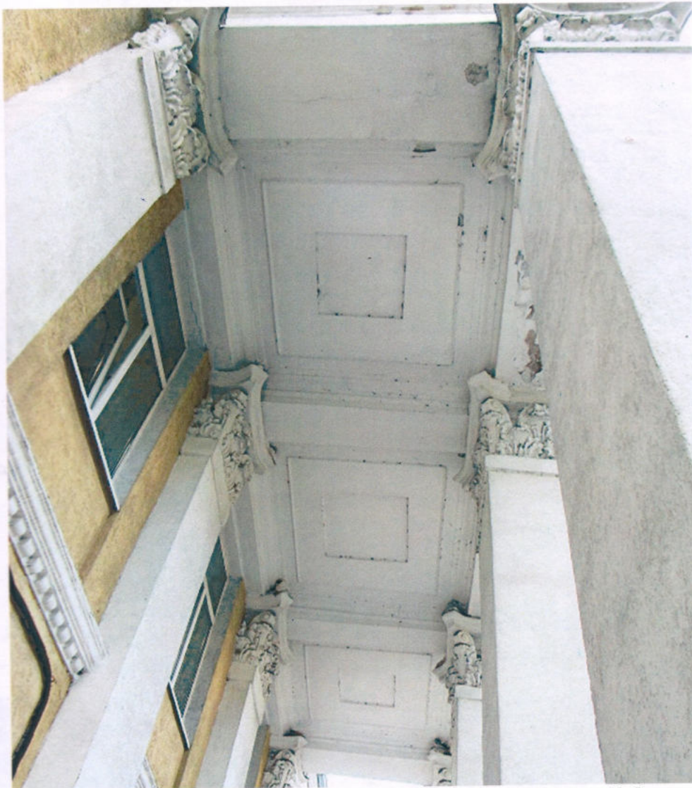
Главный фасад (северный), портик: перекрытие портика трёхпролётное, кессонное. Наблюдается нарушение штукатурного и красочного слоя.
